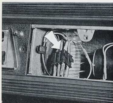
09-5 - Emplacement des fusibles sur C.A. basculante.
